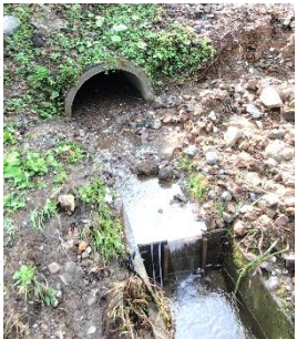
土砂でふさがった水路
